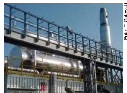
Stacja pozyskiwania metanu i agregat kogeneracyjny przy szybie VI KWK Budryk. To stąd metan popłynie rurociągiem do Chudowa.
