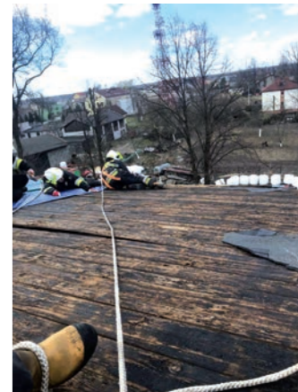
Wespół w zespół druhowie z Gierałtowiec i Chudowa zabezpieczają ogołoczone papy dach szkoły w Gierałtowiecu. Foto: arch. OSP Gierałtowiec
