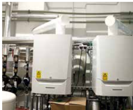
Kotłownia w ZSP w Chudowie jest już przyjazna dla środowiska. Zainstalowane w niej kotły gazowe zastąpiły węglowe „kopciuchy”.
