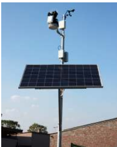
Stacja w Przyszowicach przystosowana jest do pracy niezależnie od potencjalnych przerw w zasilaniu, gdyż jest wyposażona w panel fotowoltaiczny i posiada niezależny przesył danych.
